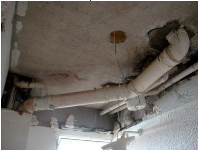
Figura 02 – Desabamento do teto de uma das casas do Condomínio Pedro Fontes Araújo (Itabuna Bahia).
